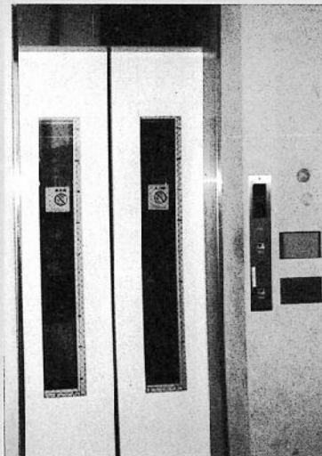
エレベーター
